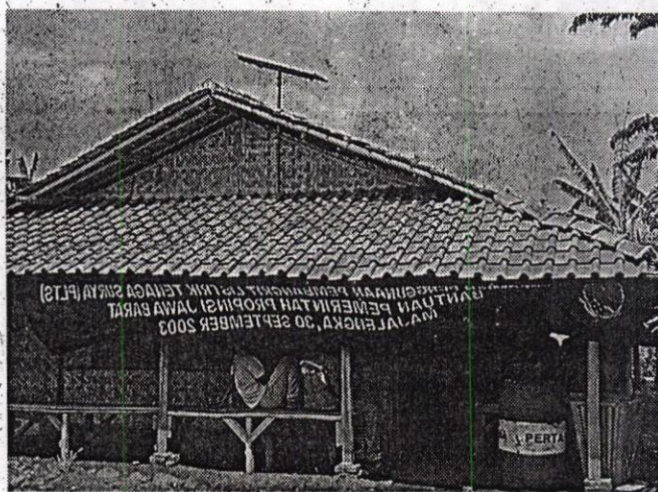
SEBUAH perangkat Pembangkit Listrik Tenaga Surya (PLTS) dipasang di rumah warga Unit Permukiman Transmigrasi (UPT) Sukamaju Dusun Kertamukti Desa Mekarjaya Kec. Kertajati Kab. Tasikmalaya.***
