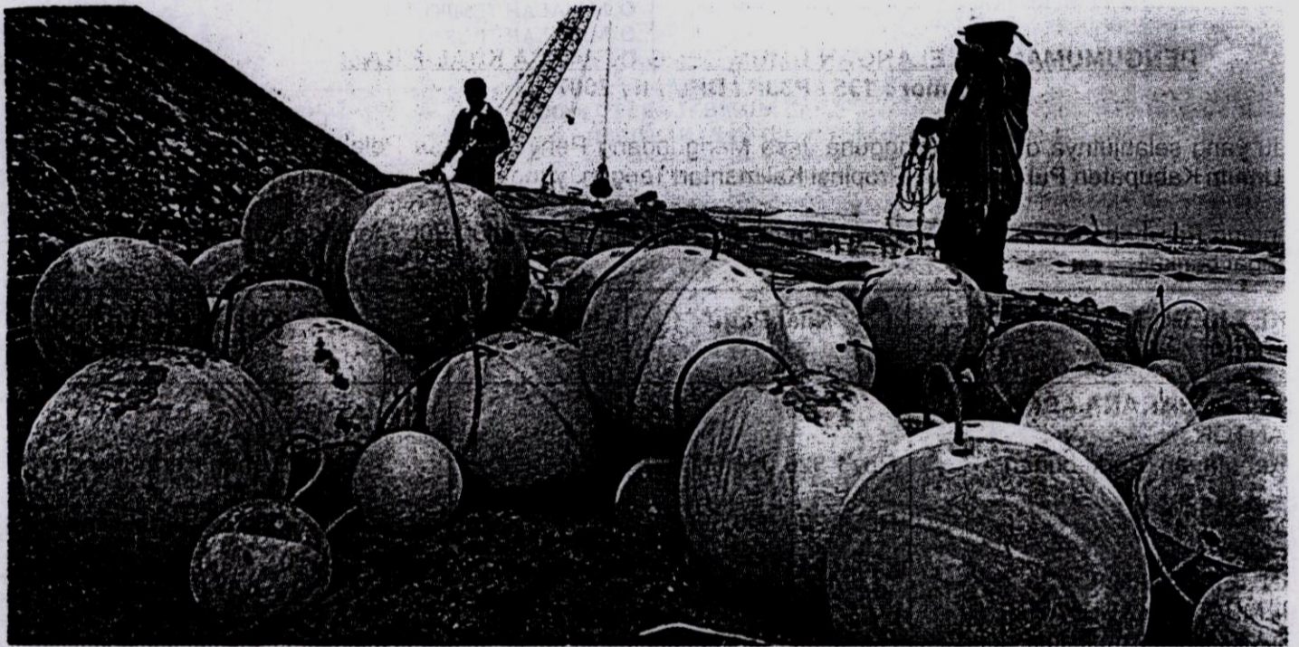
BOLA BETON: Dua pekerja memasang kawat baja pada bola-bola beton yang akan digunakan untuk menutup lubang pusat semburan lumpur panas Lapindo Brantas di Desa Siring, Sidoarjo, Jawa Timur, kemarin. Pemasangan bola-bola beton seberat 400 kg itu terhambat karena demonstrasi masyarakat dan hujan yang melanda daerah tersebut. ■ AFP/TRISNADI
